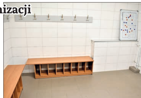
W ramach przeprowadzonej modernizacji przebudowano większość pomieszczeń na parterze, m.in. szatnie z sanitariatami
